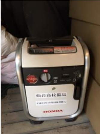
災害用 LPG 発電機
