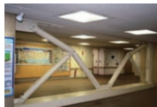
建物内部の制震装置
