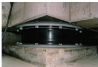
ビルの基礎の免震装置
