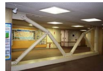
建物内部の制震装置
