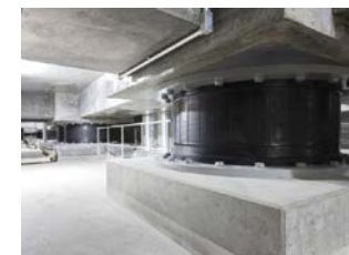
ビルの基礎の免震装置
