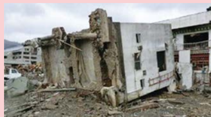
津波で倒壊したコンクリートの建物（女川町）
